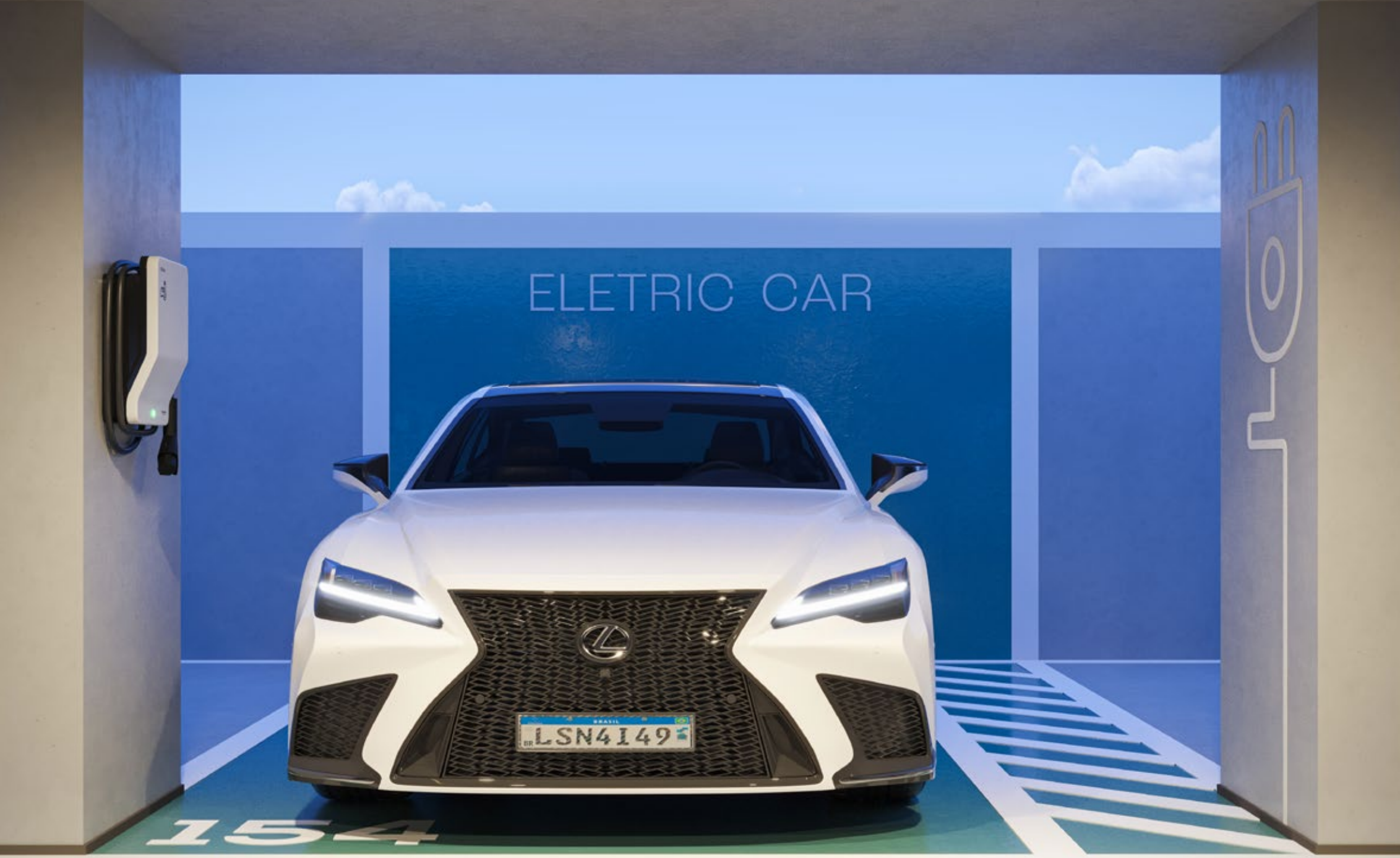
PONTO DE CARGA DE VEÍCULOS ELÉTRICOS*
